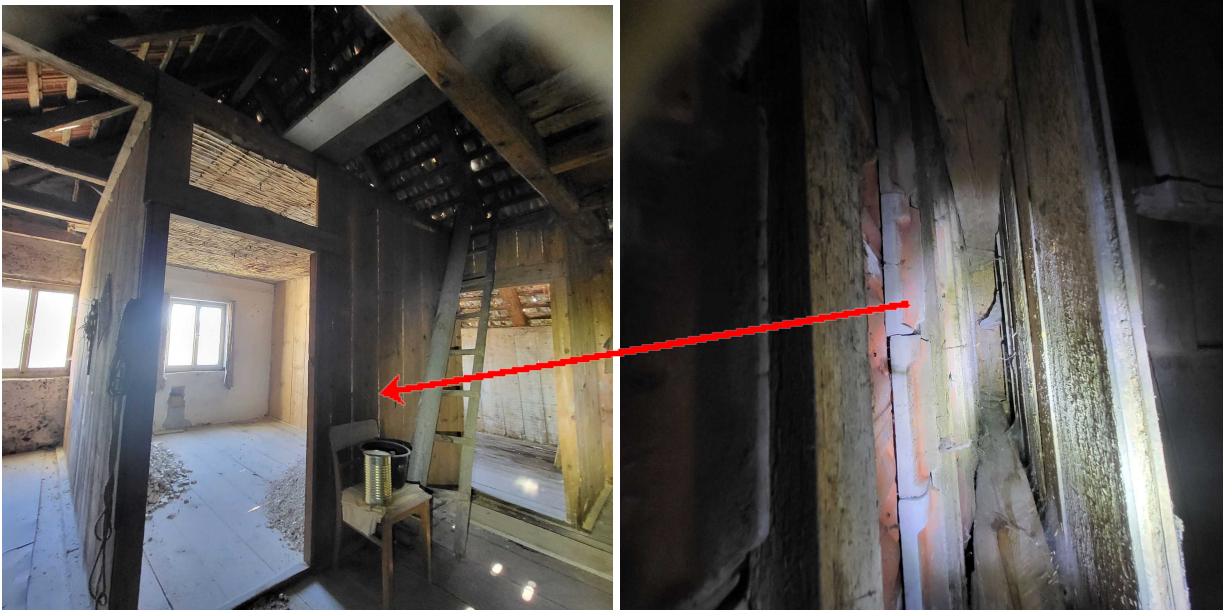
Abb. 4: Dachboden von innen und keine Zugänge über den Traufbereich.
